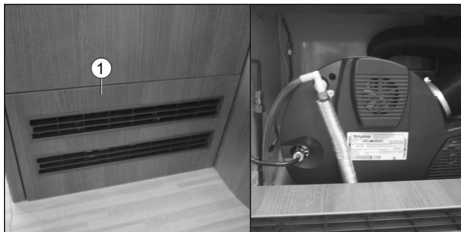
Afb. 112 Verwarming onder klerenkast
