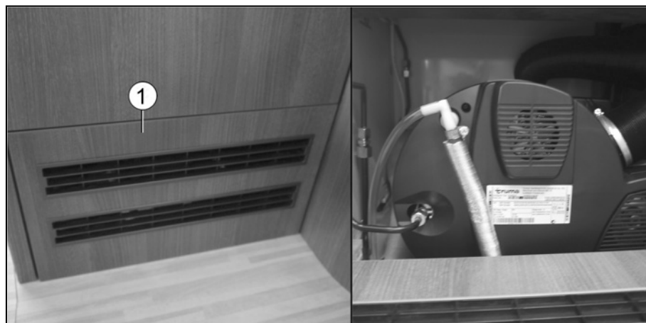
Afb. 119 Verwarming onder klerenkast
