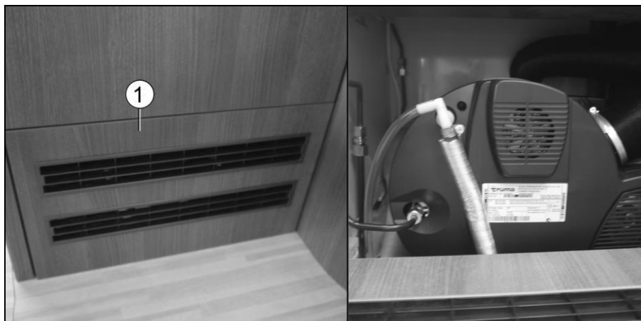
Afb. 115 Verwarming onder klerenkast
