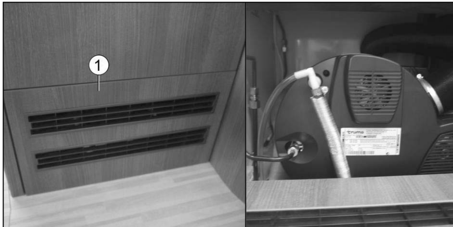
Afb. 110 Verwarming onder klerenkast
