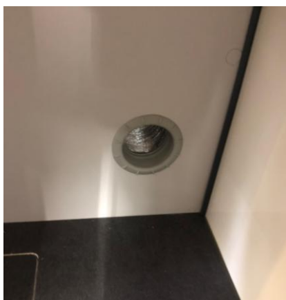
Bouche de ventilation de l'air chaud
